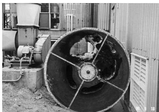
写真1 焼損した除湿ロータ
