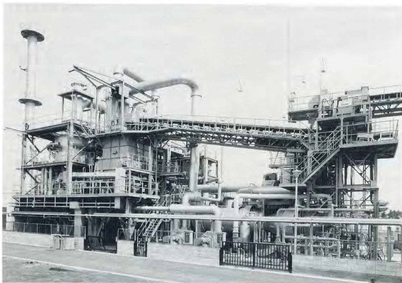
写真4 NGK 乾燥流動燃焼システム
