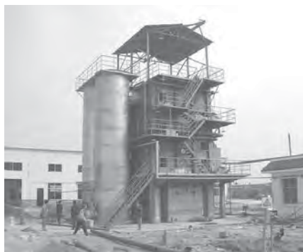
図 11 賦活炉；スーリーブ炉（ス列普炉）
